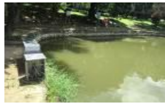
在水源區附近設置電箱
